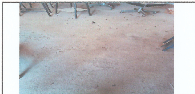
Foto 1: Mejoramiento de piso a tipo cerámico o granito en todos los ambientes del establecimiento.
